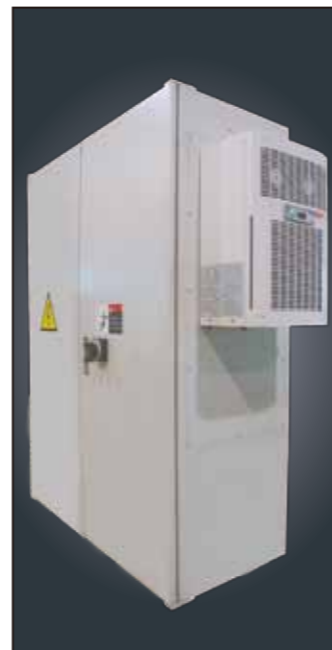
電氣箱冷氣機
